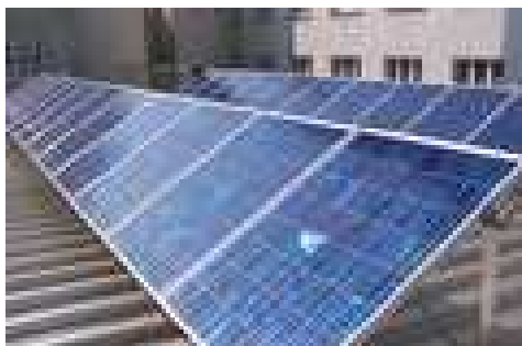
Foto: PV-Anlage Euro-Schulen-Gera
