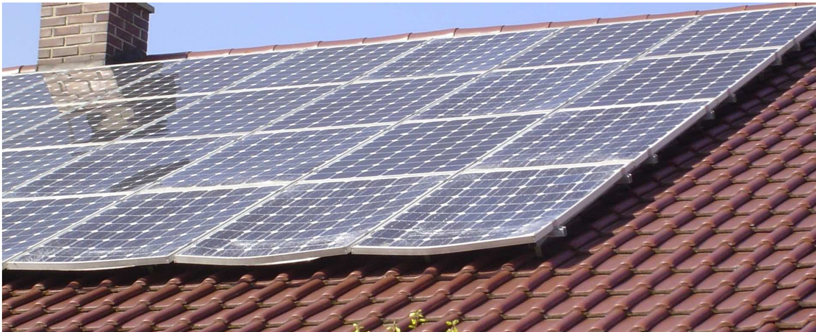
Rahmen- und Glasbruchschäden durch Schneelast
