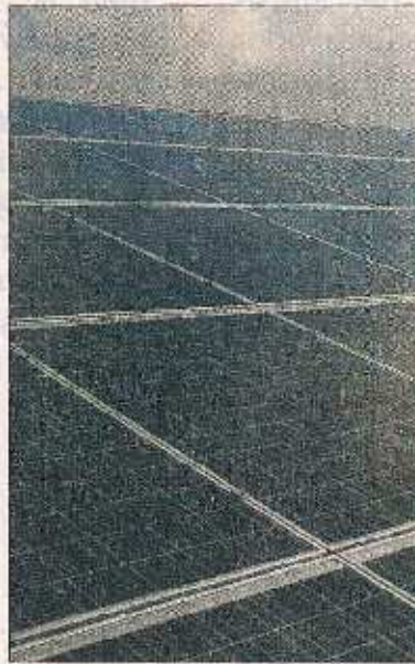
Photovoltaikanlage der Firma AEP Energie-Consult GmbH aus Gera.
